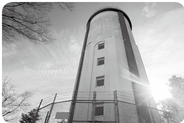
南中山高架水槽
