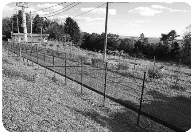
大年寺山配水所：手前取付通路と奥の林の間に地下式配水池がある
